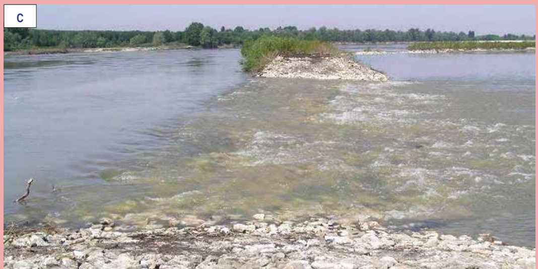
Figura 27 - a) esempio di abbassamento di un pennello lungo il fiume Po a Casalmaggiore. Il pennello evidenziato in figura (in azzurro) era parzialmente dissestato; l'intervento realizzato (tratto di 200 m, in rosso) lo ha consolidato alla quota di sfioro per una portata di 800 m 3 /s, permettendo così la riattivazione della lanca retrostante, che è stata facilitata tramite un rimodellamento del tratto terminale in corrispondenza dell'immissione nell'alveo del Po.
